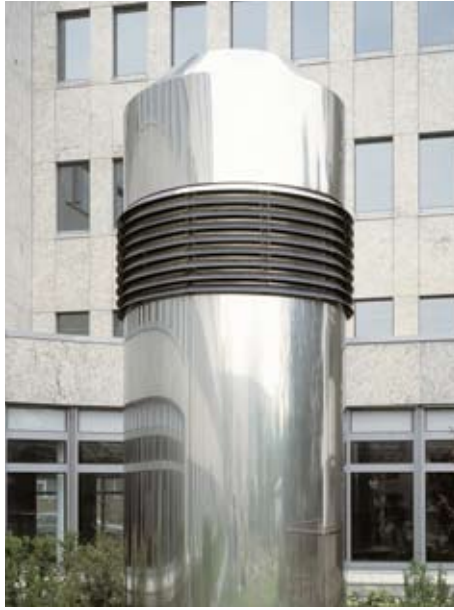
■ Kombiturm für Zu- und Abluft Objekt: Bürohaus Birkbuschstraße, Berlin Architekt: Nalbach, Berlin
